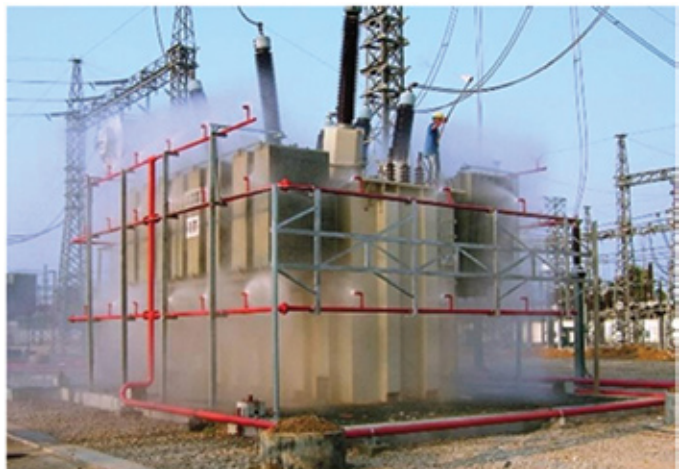
ภาพที่ ๓๓ การทำงานของระบบหัวกระจายน้ำดับเพลิงแบบเปิด เพื่อป้องกันเพลิงไหม้ของหม้อแปลงไฟฟ้าชนิดน้ำมัน
