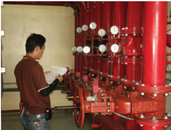
ภาพที่ ๓๘ การตรวจสอบระบบดับเพลิงด้วยน้ำ
