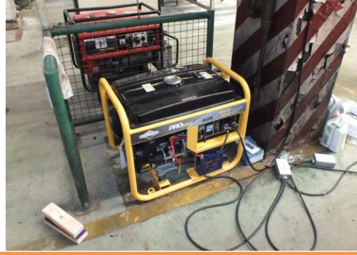
การเข้าฟื้นฟูโรงงานในขณะที่ระบบไฟฟ้าทั้งหมด ล้มเหลว จำเป็นต้องใช้เครื่องปั่นไฟสำรอง
