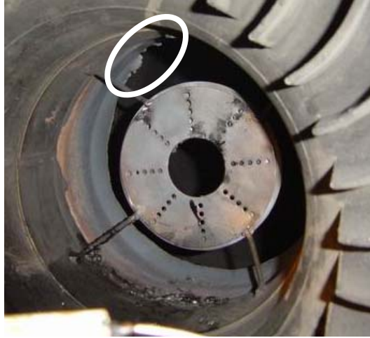
รูปที่ 6-49 กรวยไฟที่สึกหรอและเสียรูป
