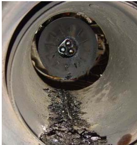
รูปที่ 6-50 คราบน้ำมันบนกรวยไฟ
