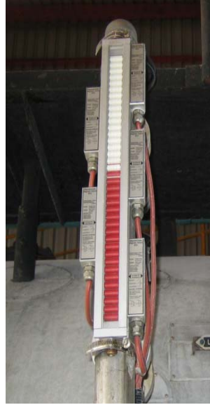
รูปที่ 4-8 อุปกรณ์แสดงระดับน้ำแบบแถบแม่เหล็ก
