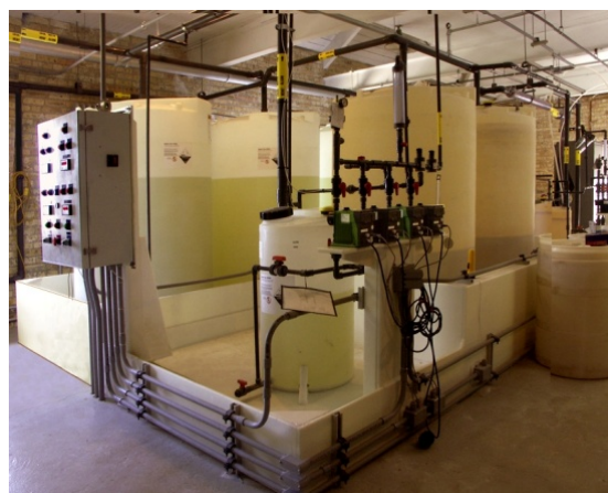
รูปที่ 5-9 ระบบเติมเคมี
